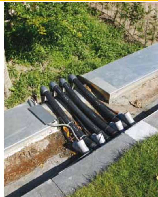
De in- en uitlaat van het afvalwater naar het grasdak.
