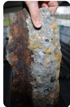
Figuur 2: Corrosie door carbonatatatie
